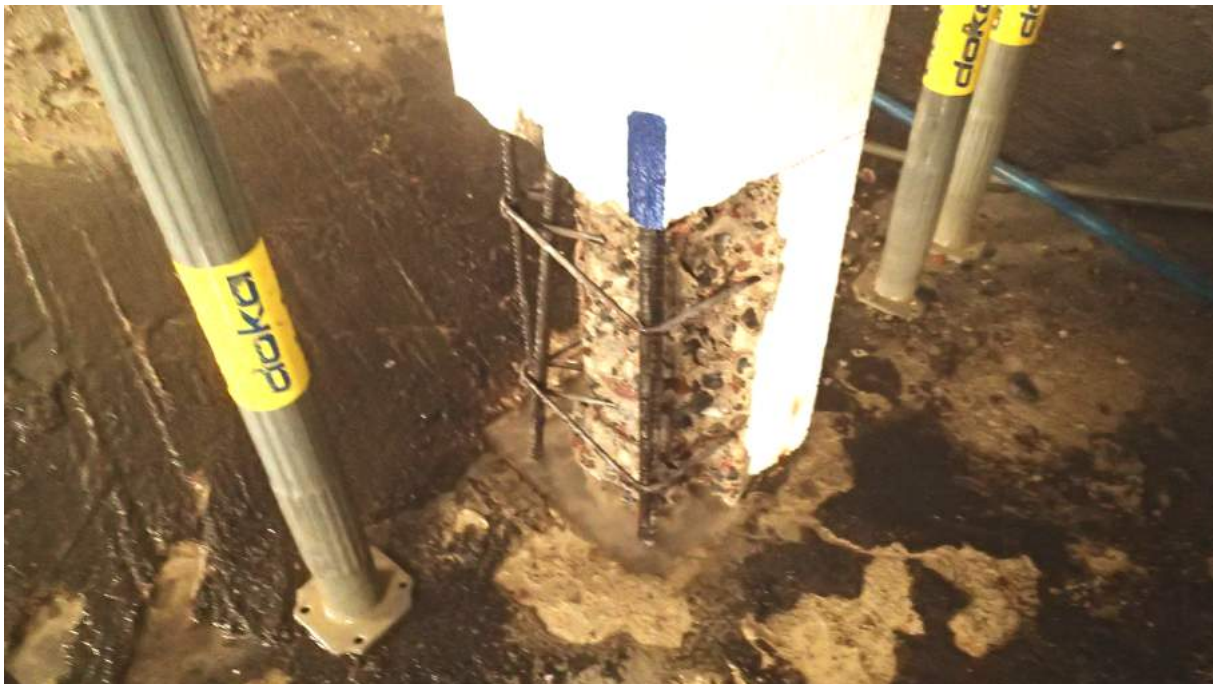
Vattenbilade pelare. Halva pelaren åtgärdas åt gången för att inte förlora för mycket stabilitet.
