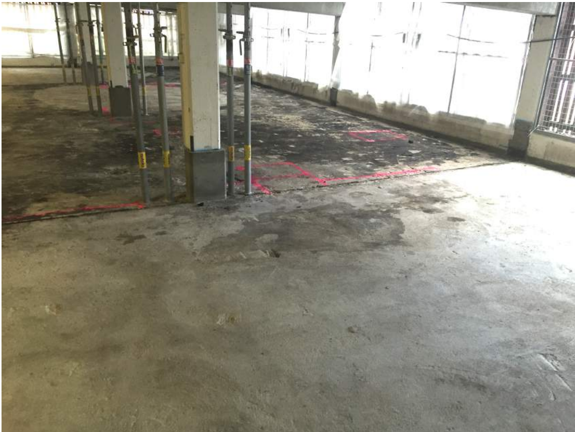
Golvskador uppmärkta med rosa spray.
