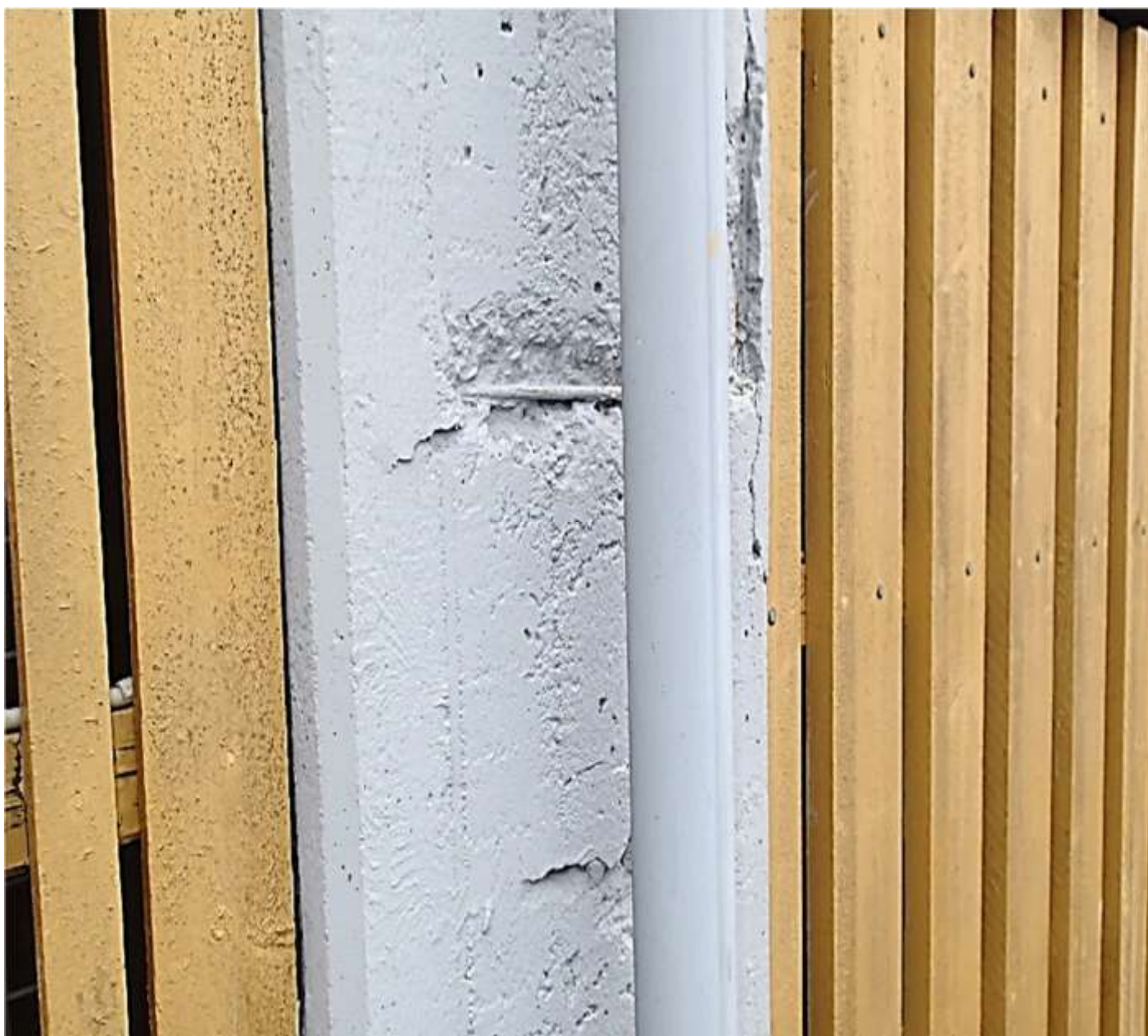
BILD 3 Skadad pelare där skadorna bara målats över
